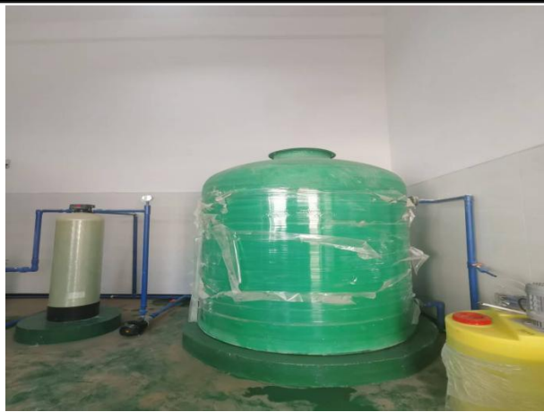
污水预处理设备
