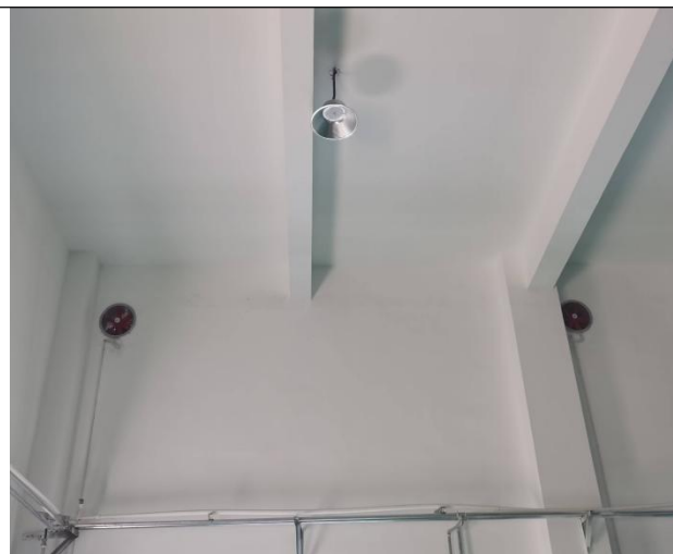
清消车间换气扇
