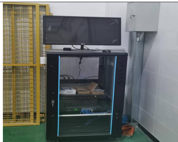
清消车间视频监控室
