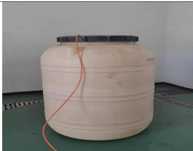
二氧化氯发生器间盐酸储罐
