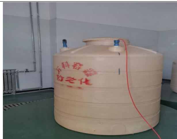
二氧化氯发生器间消毒液配液罐
